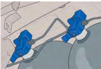
elektromagnetische Absperrventile an den Gastanks
